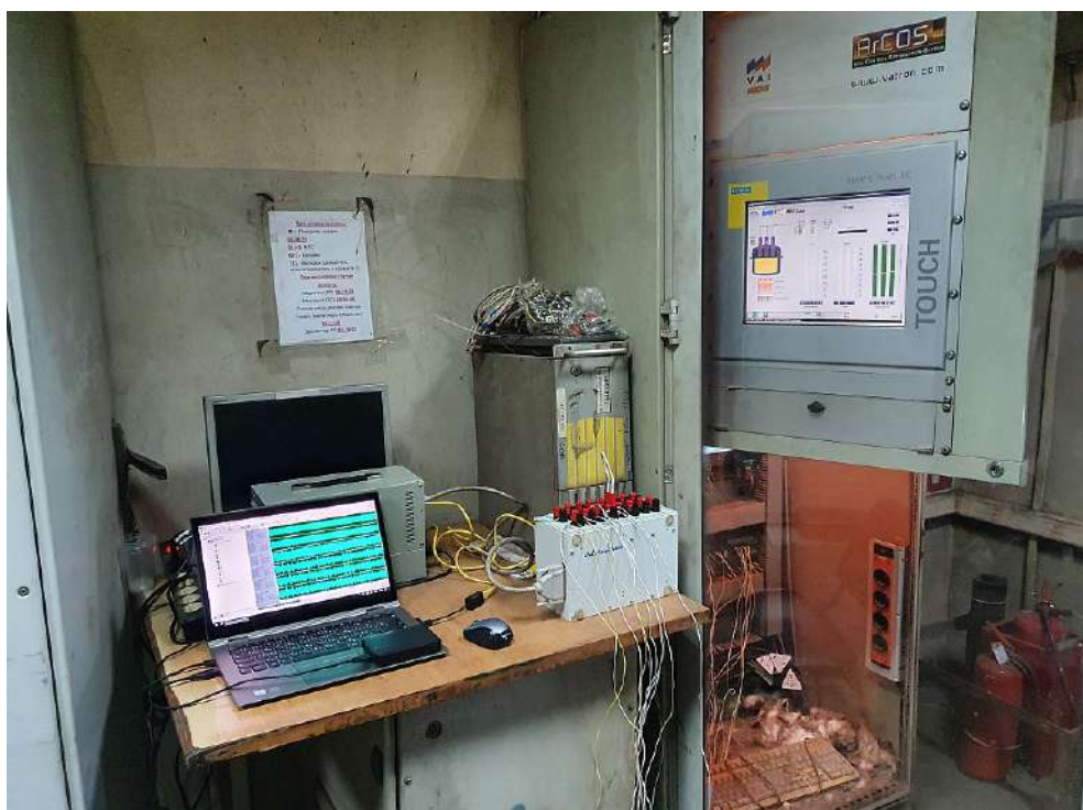
Рис.2.6 - Подключение измерительного комплекса на базе многоканального регистратора электрических сигналов РЭС-3 к измерительным цепям напряжения и тока системы управления ArCOS УКПН 2 120 т. ПАО «Северсталь»
