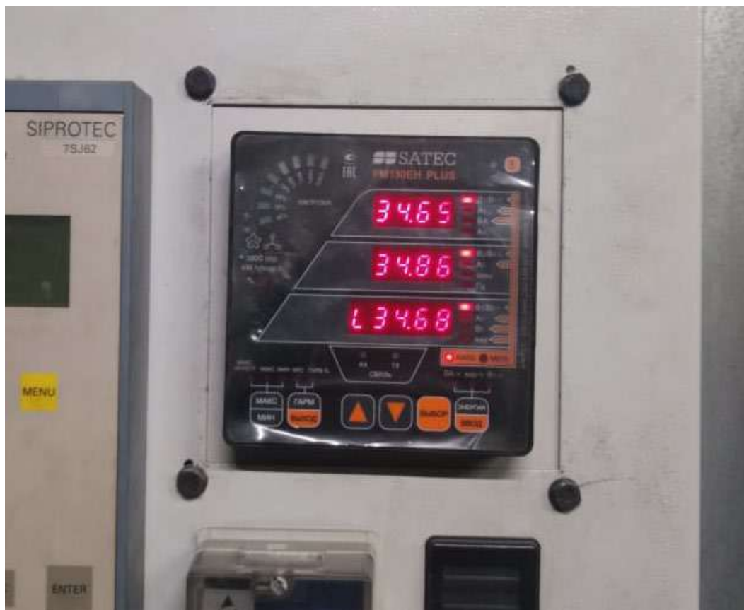
Рис. 5.15 – Анализатор мощности Satec установленный в ШУ УКП№1 180т. ПАО «ММК»
