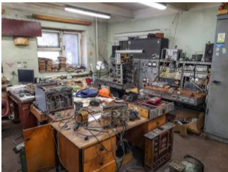
Рисунок 3 – Состояние мастерской КИПиА до усовершенствований
