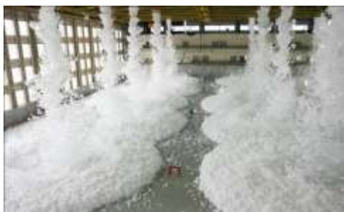
Рисунок 4 - Спринклерная установка пожаротушения
