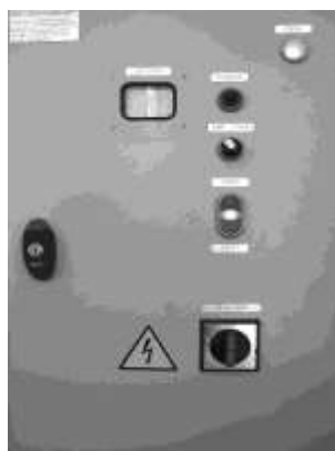
Рисунок 2 – Внешний вид шкафа управления стендом:
