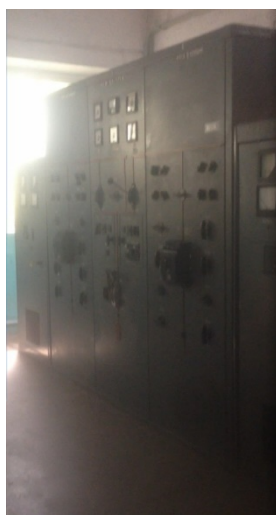
Рис 9 – Щит постоянного тока.
