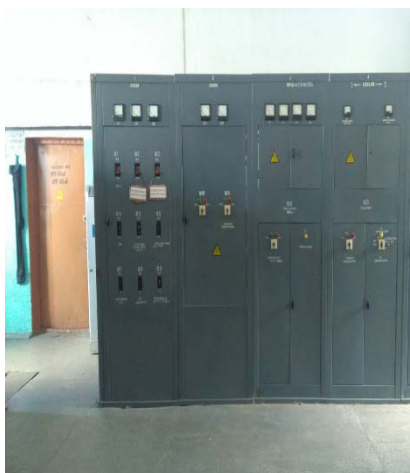
Рис. 8 – Шкаф управления обдувом трансформатора.
