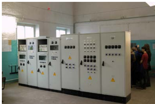
Рис 6 – Шкафы дистанционной защиты.
