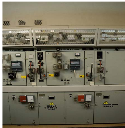
Рис 23 – Щит постоянного тока
