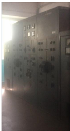
Рис 9 – Щит постоянного тока.
