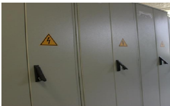
Рис 5 – Щит собственных нужд
