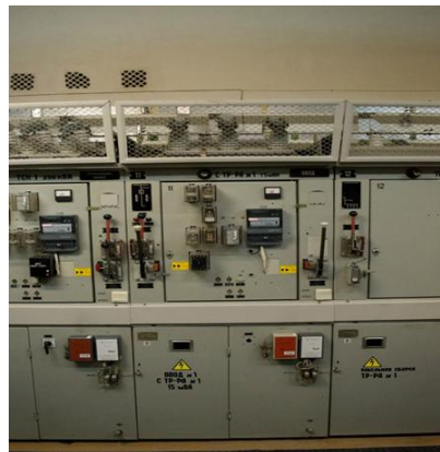
Рис 23 – Щит постоянного тока
