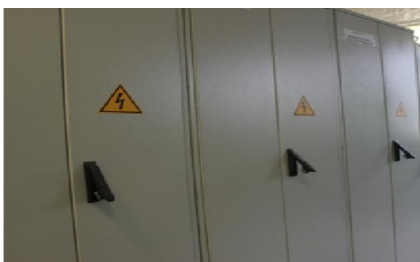
Рис 5 – Щит собственных нужд
