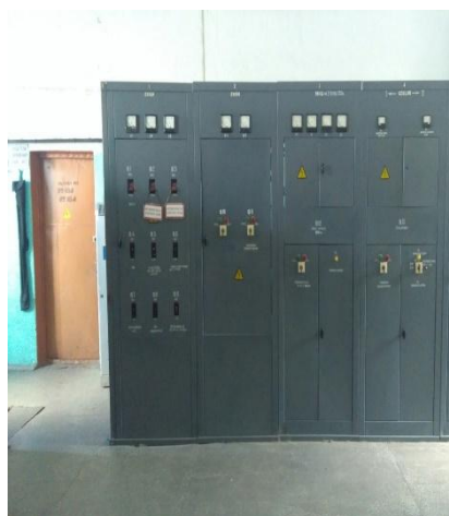
Рис. 8 – Шкаф управления обдувом трансформатора.
