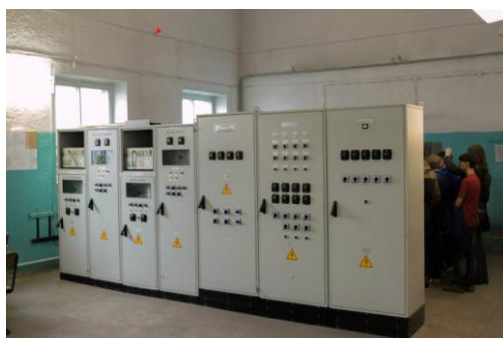
Рис 6 – Шкафы дистанционной защиты.
