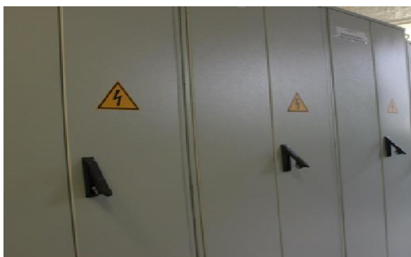
Рис 5 – Щит собственных нужд
