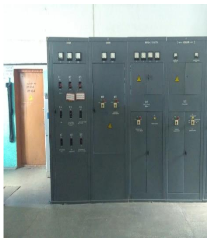
Рис. 8 – Шкаф управления обдувом трансформатора.
