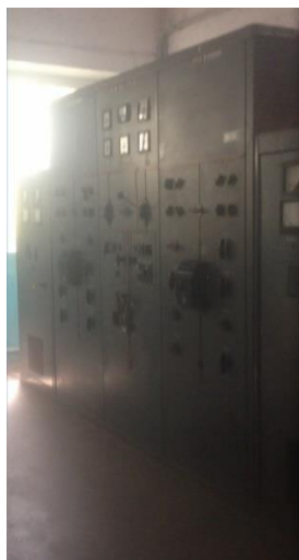
Рис 9 – Щит постоянного тока.
