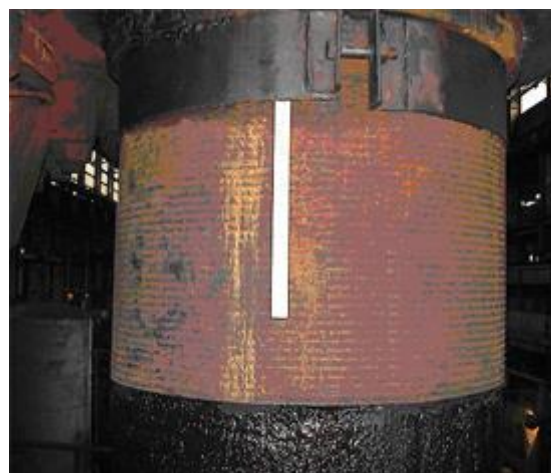
Рис. 4. Общий вид полностью разрушенной внутренней резьбы колонны под архитравом прессы силой 100 МН для объемной штамповки. Диаметр колонны 800 мм
