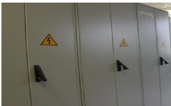
Рис 5 – Щит собственных нужд
