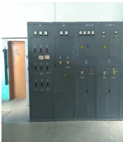
Рис. 8 – Шкаф управления обдувом трансформатора.
