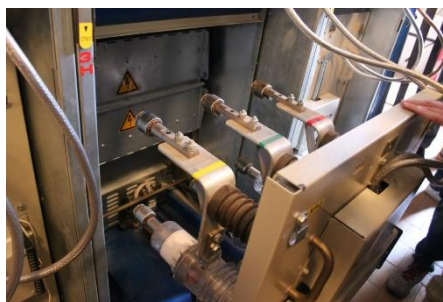
Рис №37 – вакуумный выключатель
