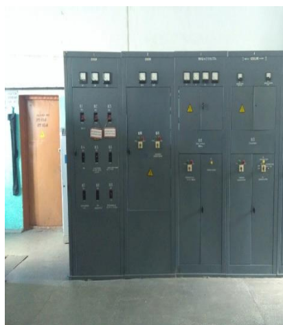
Рис. 8 – Шкаф управления обдувом трансформатора.
