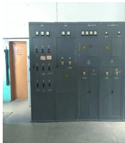
Рис. 8 – Шкаф управления обдувом трансформатора.
